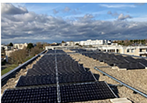
Bâtiment Providence Poitiers : une première installation photovoltaïque en autoconsommation de 89 kWc
